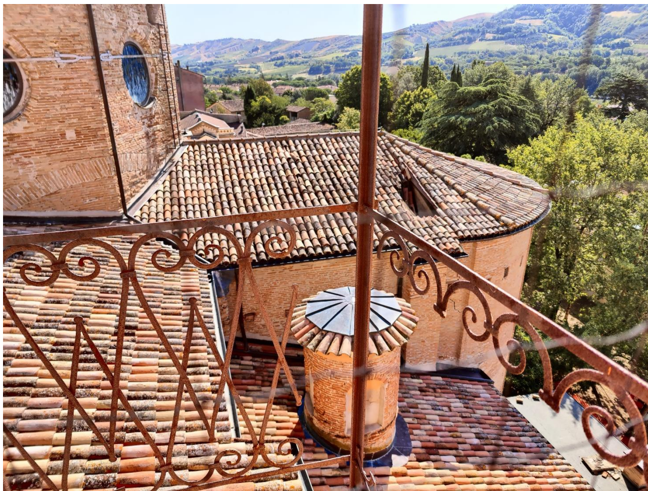
Figura 9 – Lo sfilamento delle travi del coperto dall'appoggio sul muro sopra l'arco ha causato un cedimento di una porzione.
