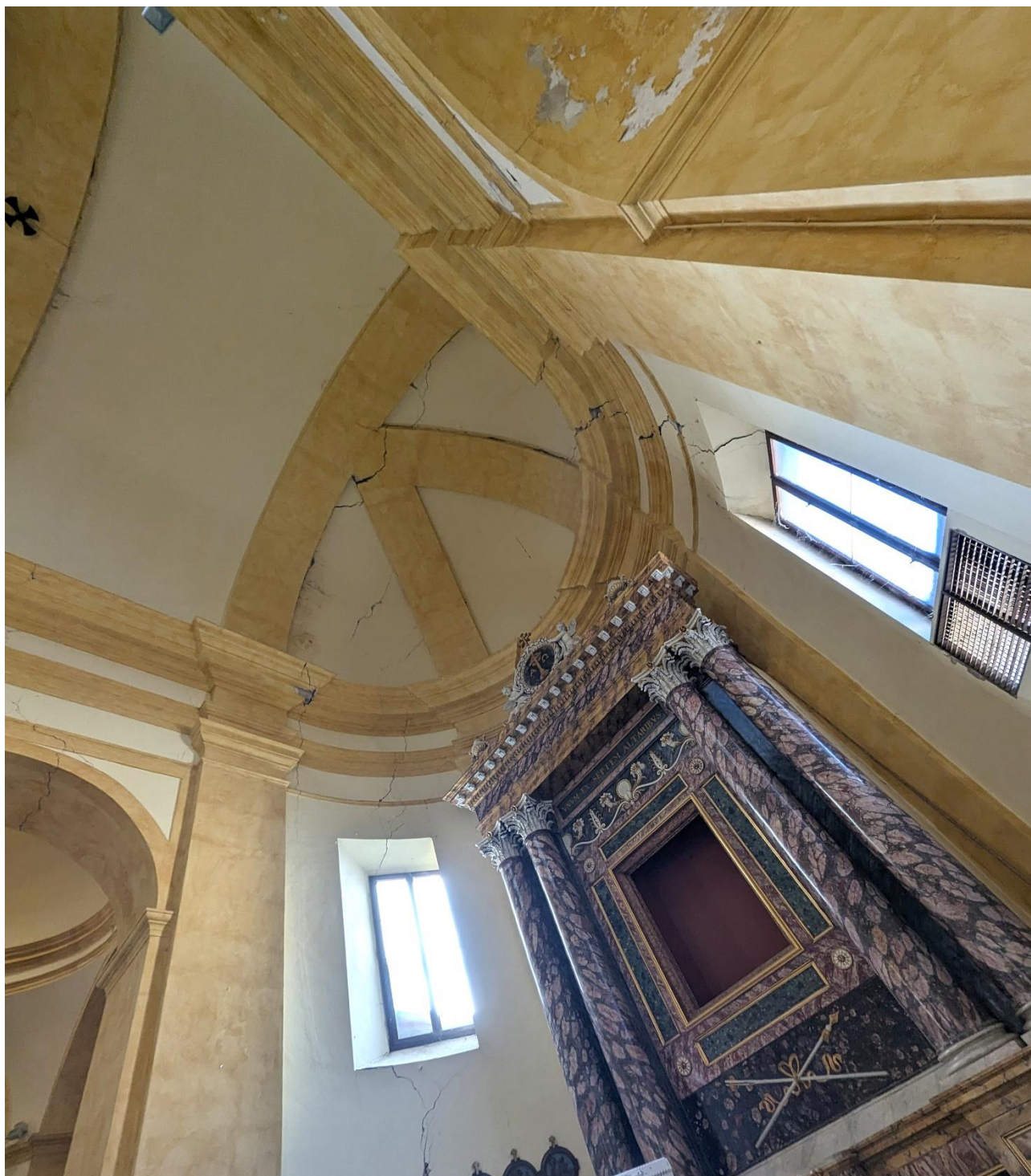
Figura 5 – Il quadro fessurativo della cappella laterale al momento dell'inizio del cantiere.
