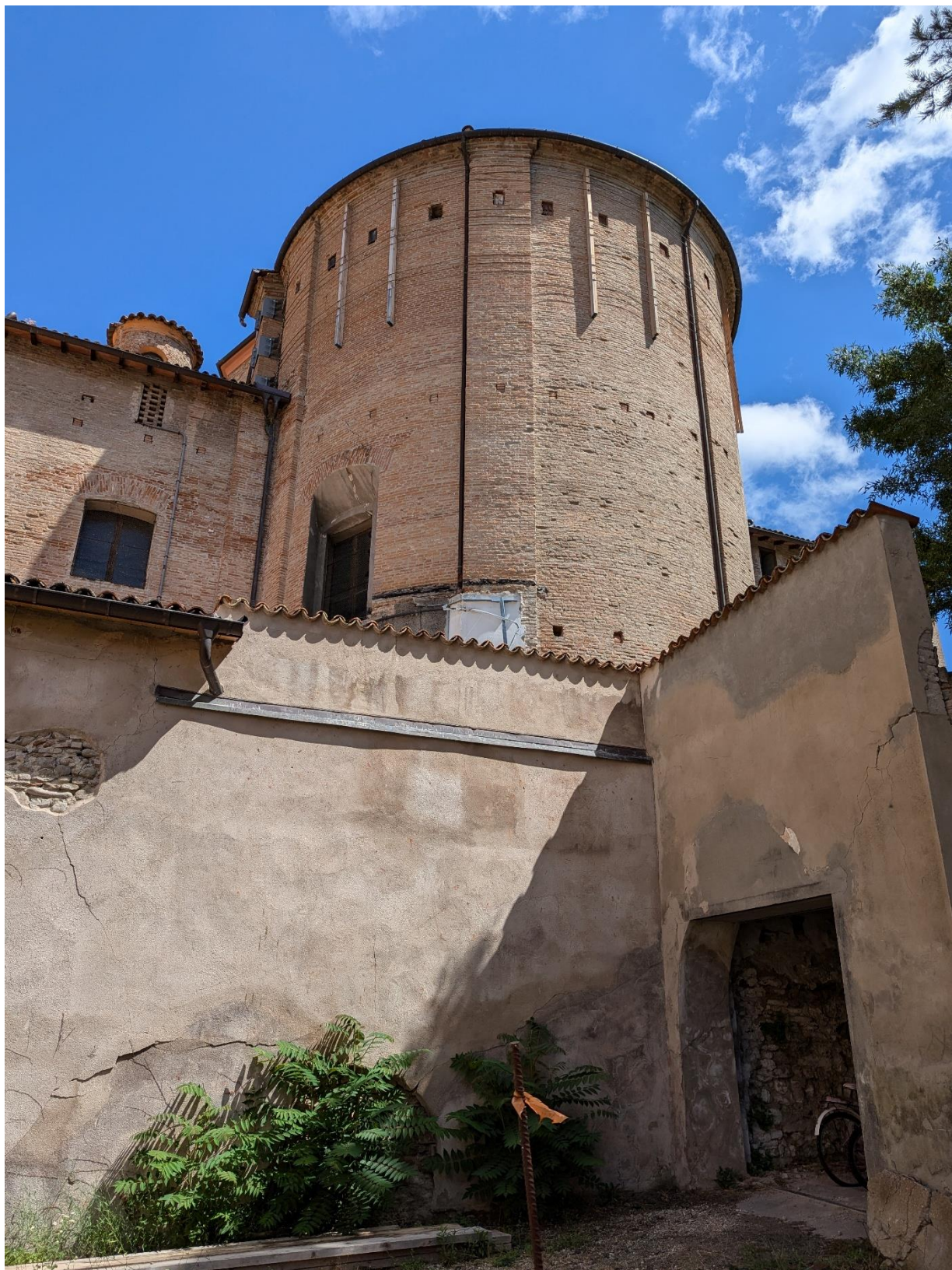
Figura 10 – Il presidio di messa in sicurezza di somma urgenza operato mediante trefoli in acciaio inox
