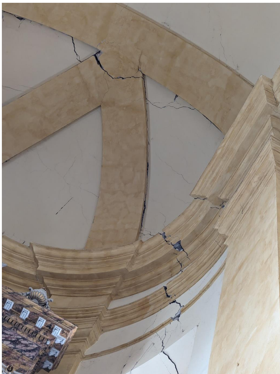
Figura 6 – Particolare del quadro fessurativo
